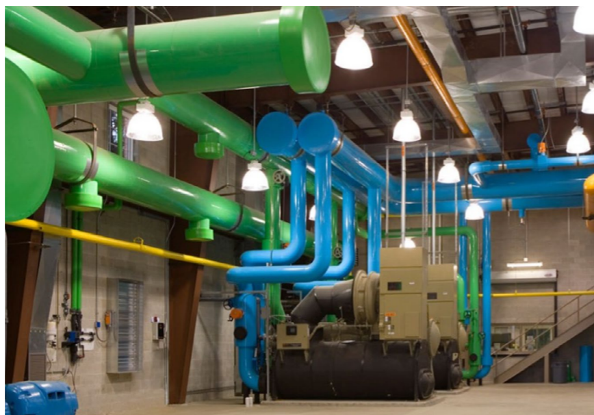
الشكل 27: أنظمة التبريد داخل إحدى محطات تبريد المناطق (شركة أرامكو ARAMCO)
